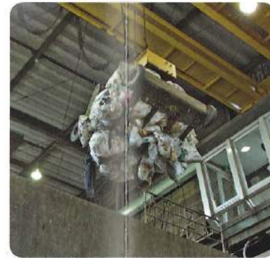
●ごみクレーン
