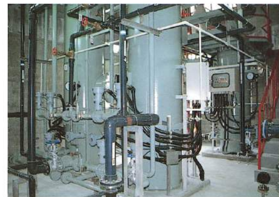
■高度処理設備
